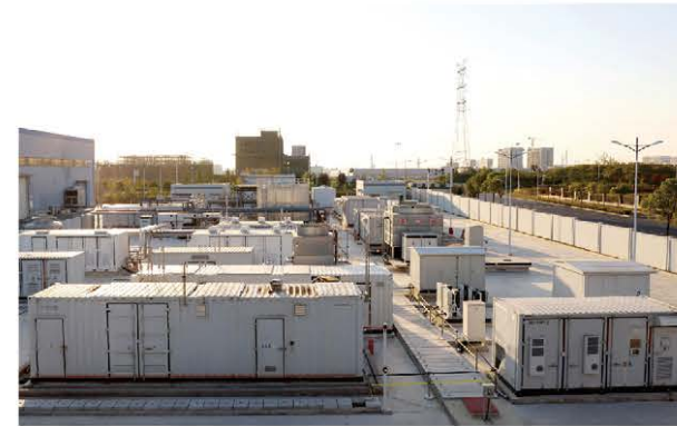
可再生能源变功率制氢及氢储能发电实证平台
