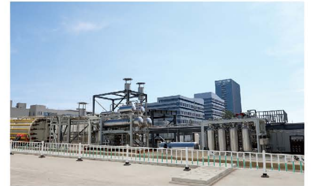
电解水制氢系统综合测试平台
